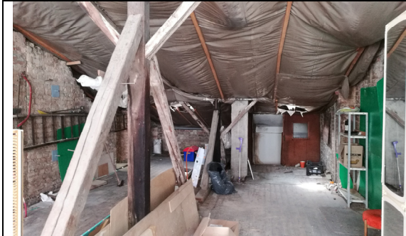
Abb. 7: Dachboden im Verfall begriffen
